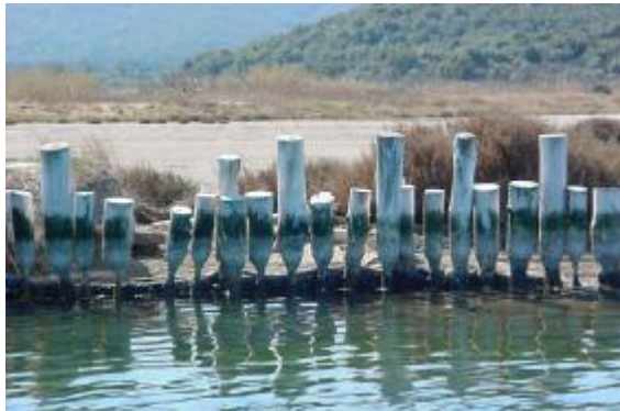
Fig. 11.6 Palificate in stato di degrado a Terrarossa
